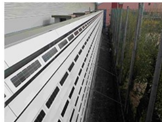
②太陽光発電設備
