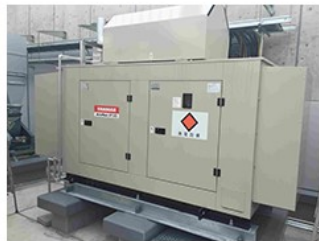
①非常用発電機
